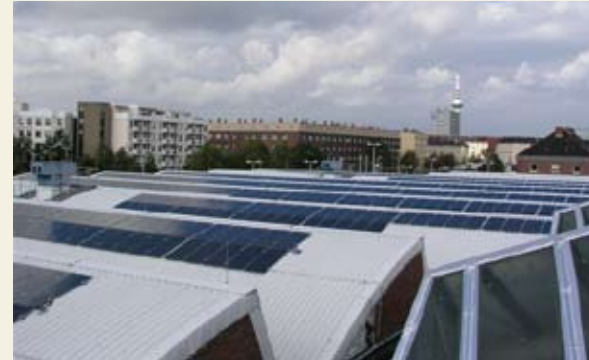
Solaranlage, Quelle: MVV Energiedienstleistungen GmbH, Gühr
